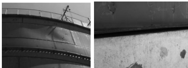
图1 发生倾斜后的油罐侧壁
