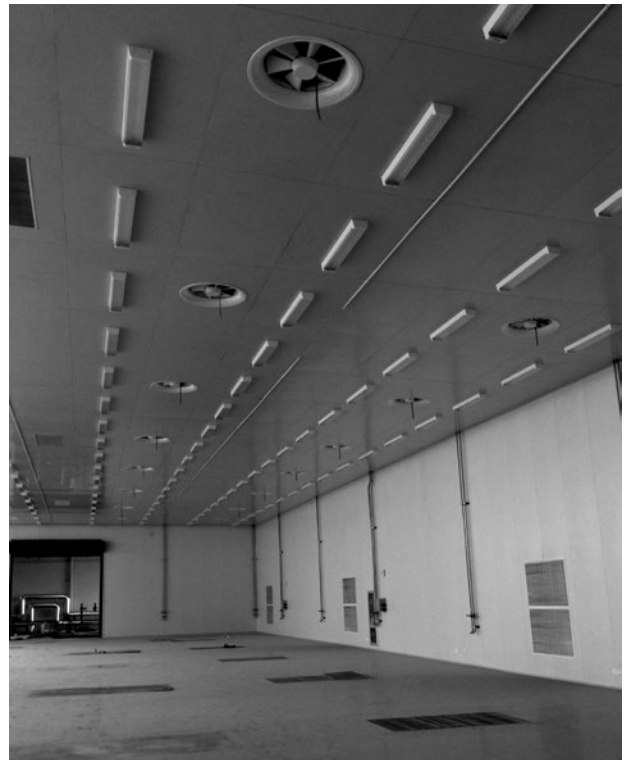
图4 铺叠间室内内景2
